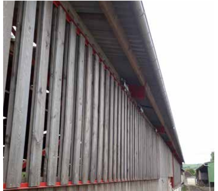
Photo 14 bardage bois modulable (Crédit photo : Idele)
